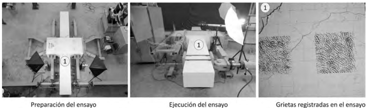
Figura 2. Registro de deterioro superficial en una unión viga-columna de concreto reforzado con fibras de acero adicionada.
