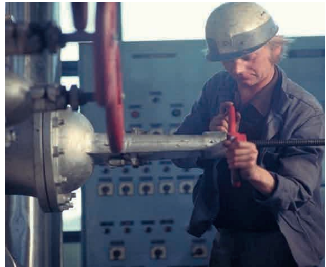
Figura 3. Control manual en una central térmica.
